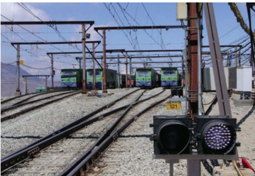
Напольное оборудование на железной дороге «Teniente 8»
